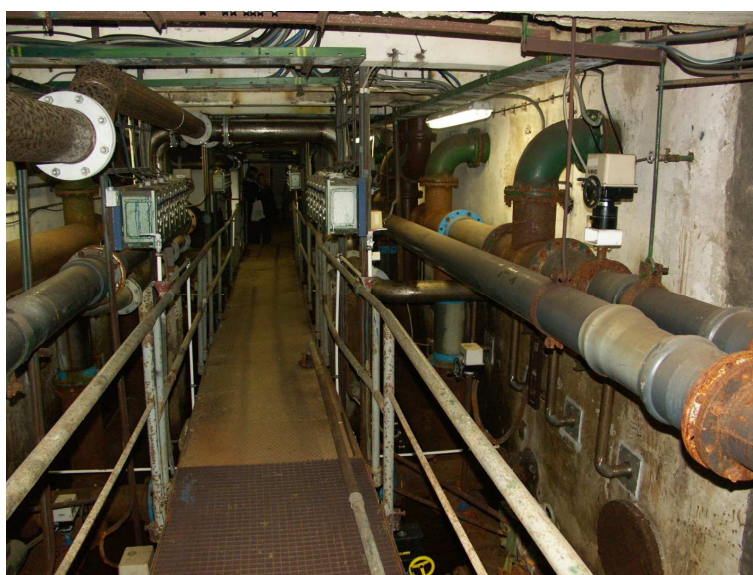
Obr. 3. Armaturní chodba rychlofiltrů – stav před rekonstrukcí
